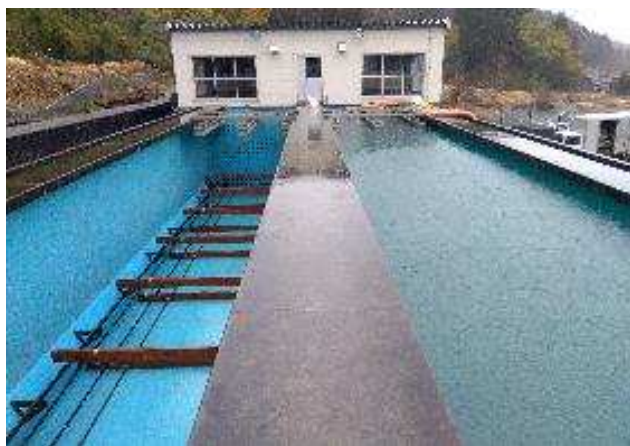
浄水場の被害（珠洲市）
