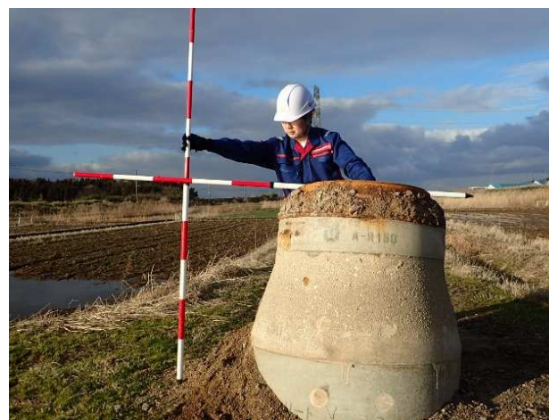
マンホール浮上現場（中能登町）
