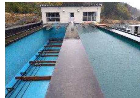
浄水場の被害(珠洲市宝立浄水場)
