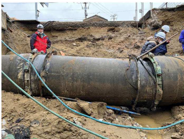
送水管の被害（七尾市）
