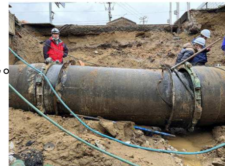
送水管の被害(七尾市)
